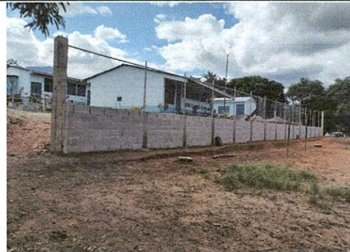
Foto 2: Fotografía evidencia la necesidad del muro perimetral
