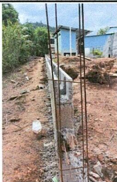
Foto 3: Evidencia la necesidad de muro perimetral
