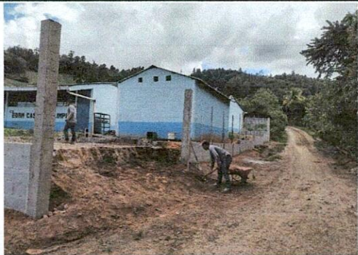
Foto 1: Fotografía, evidencia la necesidad de muro perimetral, por la circulación de vehículos en la carretera que conduce a Chacalté y Pampacay
